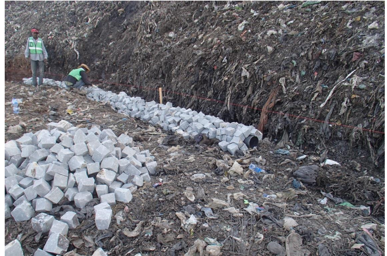
Installation d'un tuyau de collecte des lixiviats à la décharge de Koshe (Rappi) (2018)
