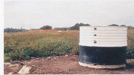
ガス抜き設備の効果により、植生が回復
